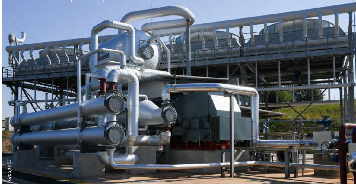
Centrale géothermique de Soultz-Sous-Forêt (Bas-Rhin)
