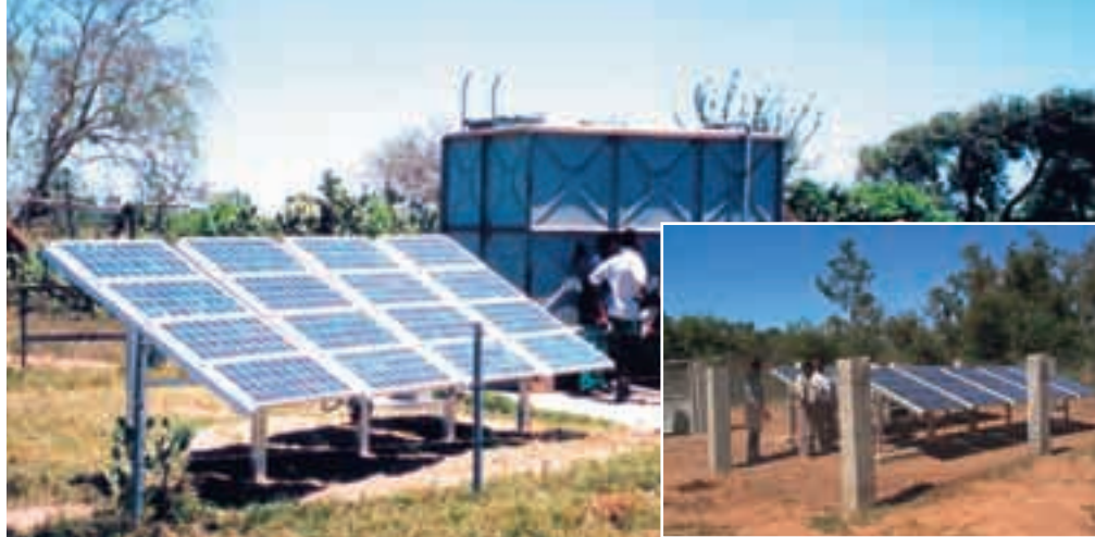
Les pompes solaires débitent entre 8 et 20 m 3 d'eau par jour. Ici, les installations de Ambodro et Antanimore. / Daily out put of the solar pumps is from eight to twenty m 3 . Here solar pumps of Ambodro and Antanimore.
