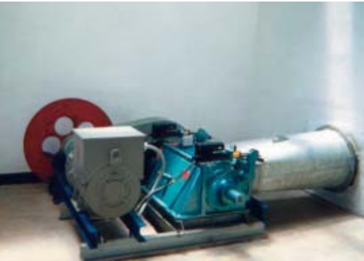
La génératrice de 42 kW./The 42 kW generator.
